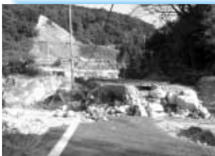
県道鳥飼浦洲本線 洲本市奥畑付近で道路が大きく崩落
