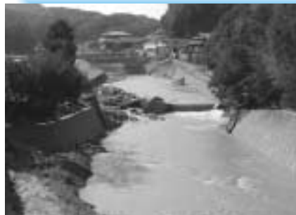
沈下橋決壊 都志川鮎原吉田地区
