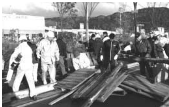
避難路の障害物を排除します
