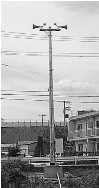
千草川に設置されたサイレン
