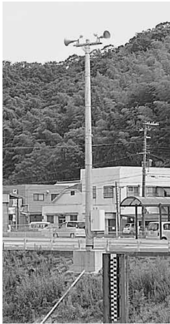
洲本川に設置されたサイレン
