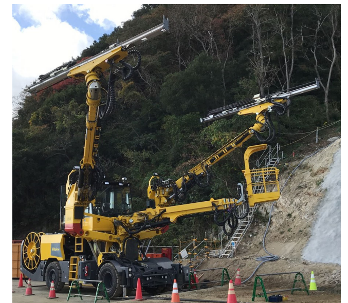
トンネル掘削使用機械 コンピュータジャンボ （鋼棒でダイナマイトを込める孔を開けます。 コンピュータにより自動制御も可能です。）
