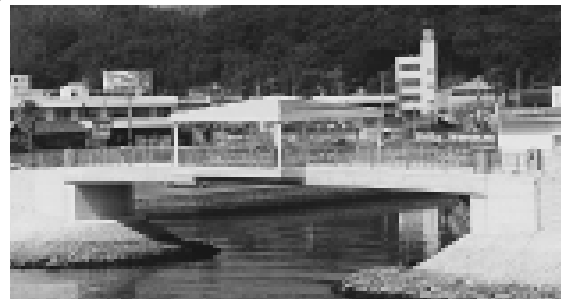
完成間近のウォーキングトレイル遊歩道 陀仏川歩道橋
