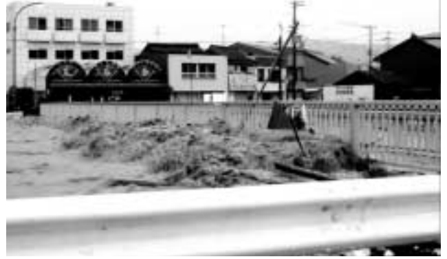
水が橋上にあふれ出した物部橋
