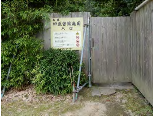
写真Ⅳ-57 入口周辺の板塀支柱露出
