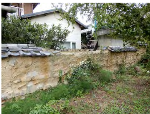
写真IV-44 土塀の老朽化
