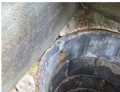
写真IV - 49 構造物の劣化
