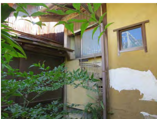
写真IV - 50 書院建築の老朽化
