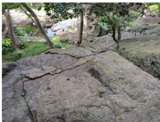
写真IV - 47 石組の割れ・剥離
