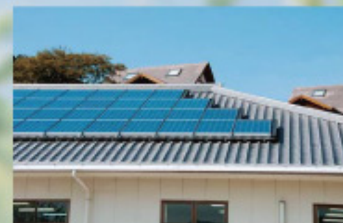
太陽光発電パネル Solar panels
