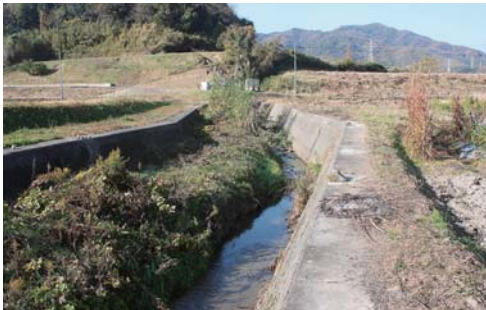
▲河川の土砂堆積状況
