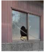
窓が割れた管理不全空家
