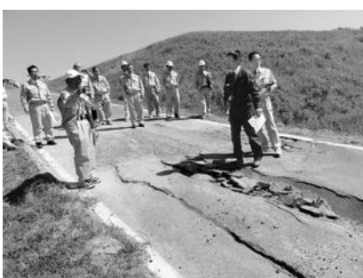
▲被災した農道を調査（中川原町二ツ石）
