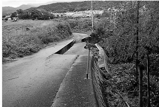
▲台風11号の大雨で道路決壊した箇所
