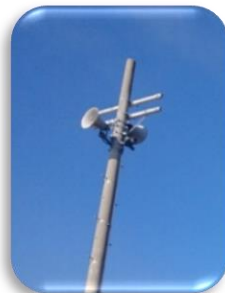
（屋外防災スピーカー）
