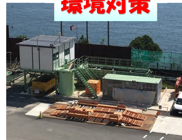
仮設備工 濁水処理設備
